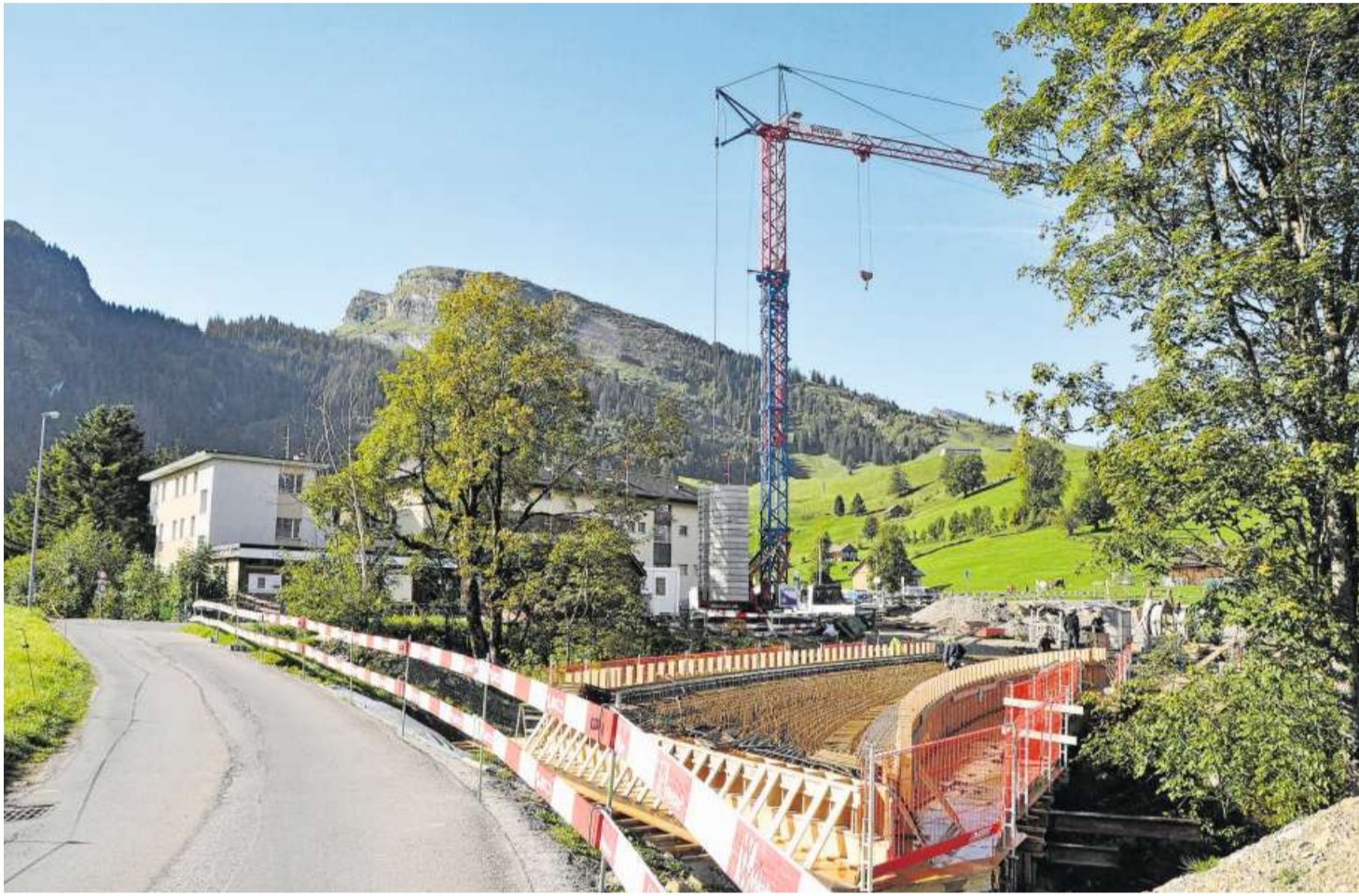
Der Bau des Klanghauses macht nötig, dass die Schwendistrasse umgelegt wird. Derzeit wird die neue Brücke erstellt. Bild: Sabine Camedda
